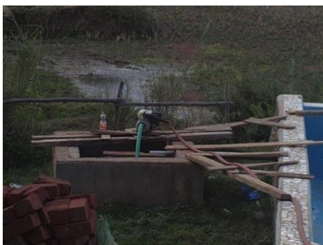
Figure 8: Source captée alimentant les nouvelles installations
